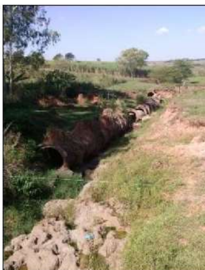
Imagem 2: Ponto de lançamento, em 2016, das águas pluviais na sub-bacia 2 (Ribeirão dos Macacos)
