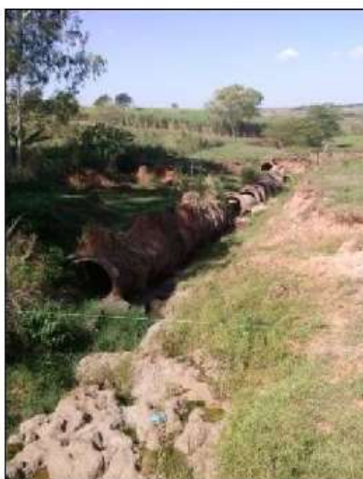
Imagem 2: Ponto de lançamento, em 2016, das águas pluviais na sub-bacia 2 (Ribeirão dos Macacos)
